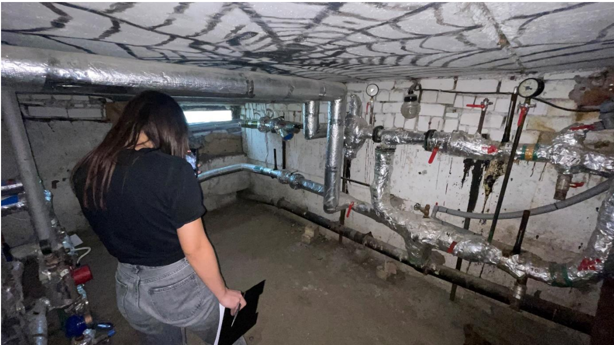
Pav. 14. Komunikacijų vamzdynų būklė
