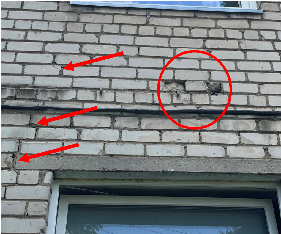
Pav. 8. Sienų defektai: vertikalūs plytų mūro plyšiai, apskilinėjęs mūras
