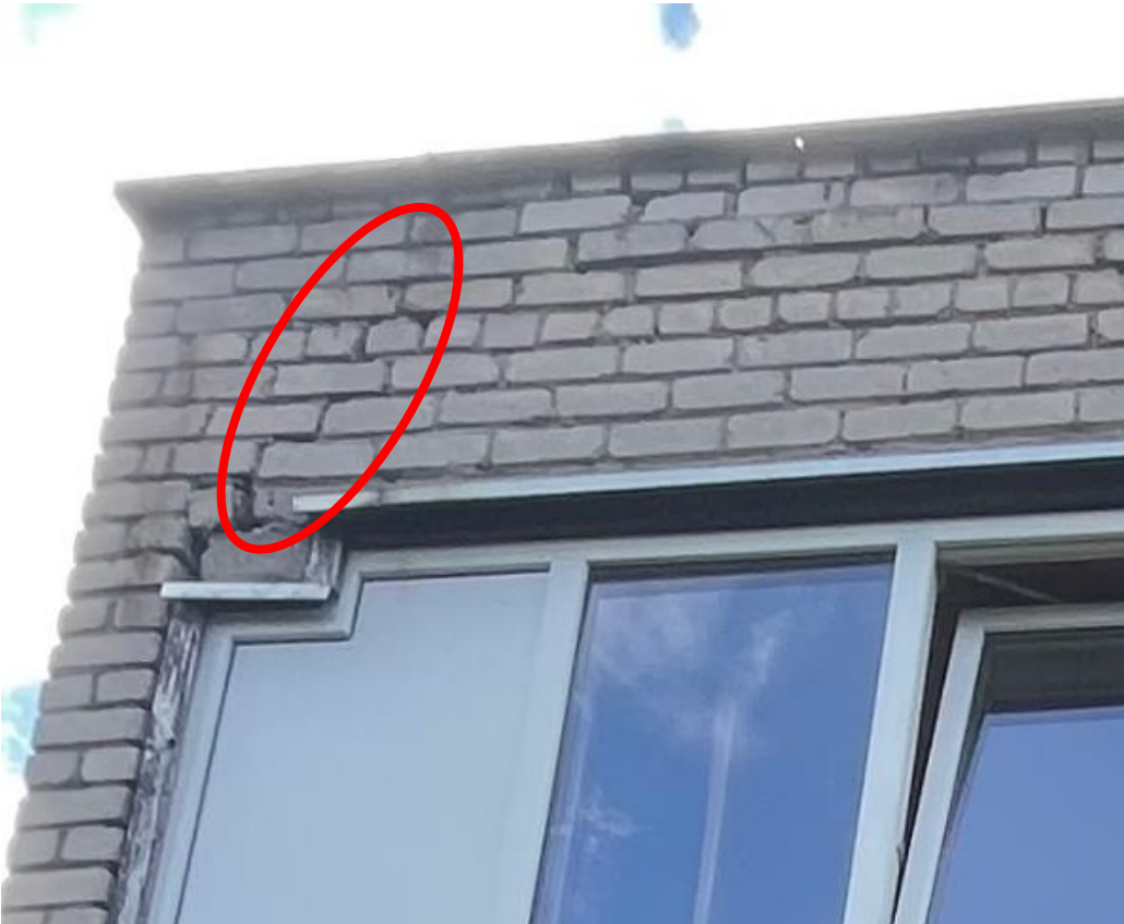
Pav. 9. Sienų defektai: vertikalūs plytų mūro plyšiai
