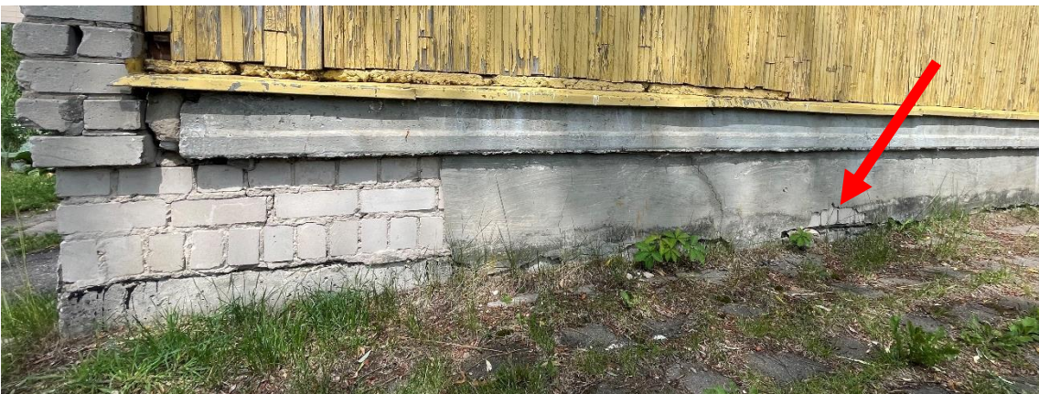
Pav. 7. Cokolio ir nuogrindos defektai
