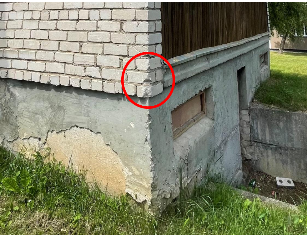
Pav. 10. Sienų defektai: apskilinėjęs mūras
