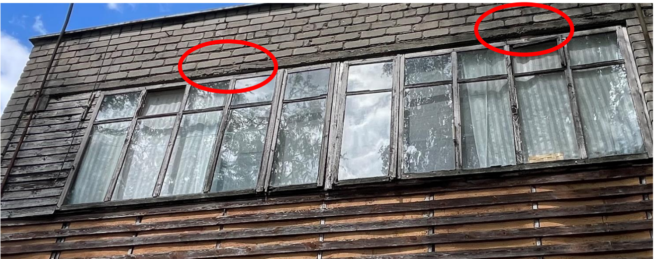
Pav. 12. Balkonų defektai: apskilinėjęs balkono perdangos plokštės betonas
