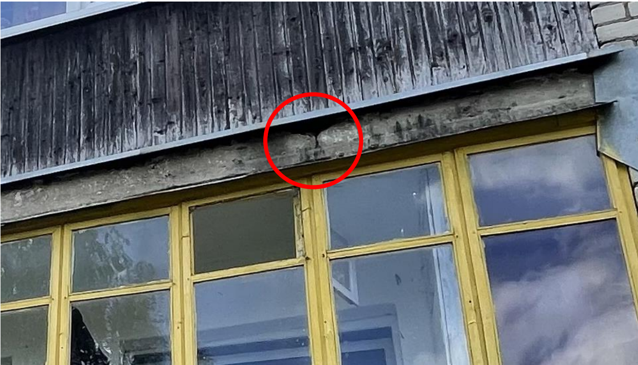
Pav. 13. Balkonų defektai: atskilęs balkono perdangos plokštės betonas
